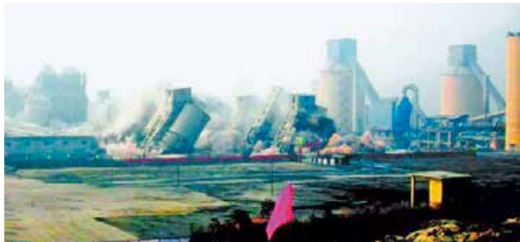
爆破9条机立窑水泥生产线
