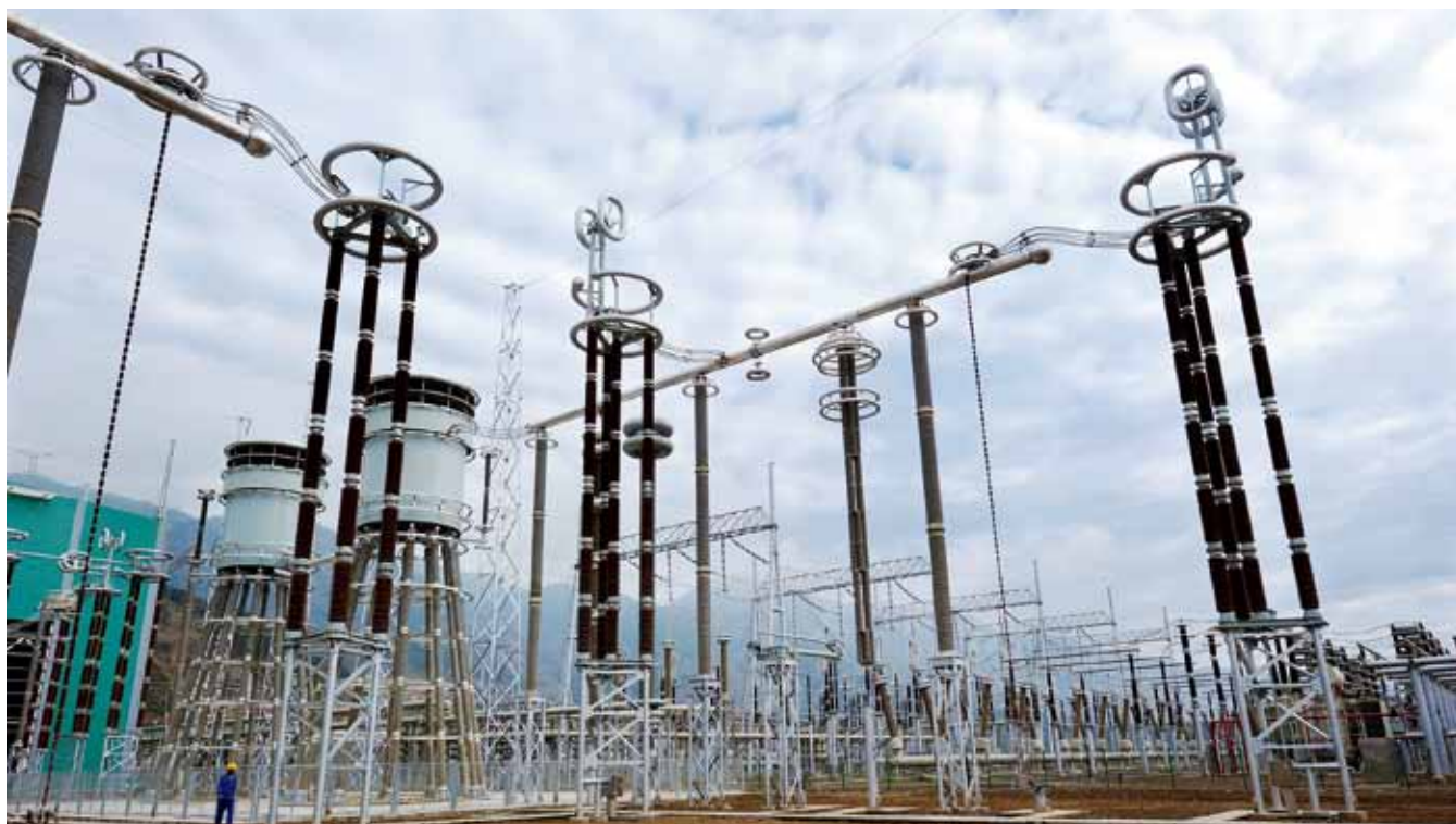
苏南直流±800KV工程
